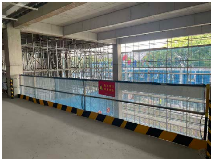
楼层内临边防护
