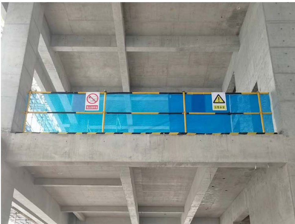
楼层内临边防护
