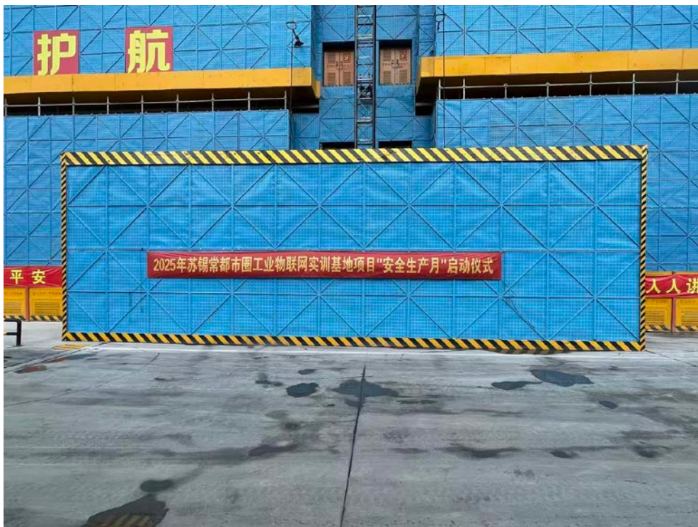
施工电梯接料口立面防护
